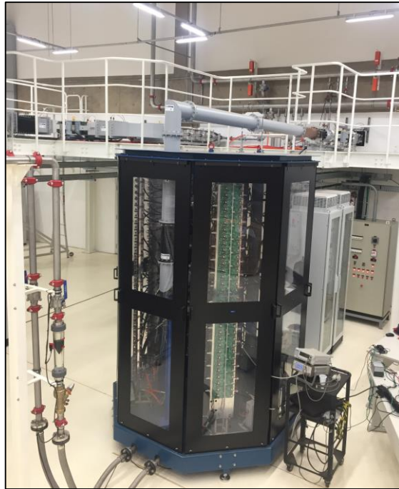
Booster 45kW SSA
